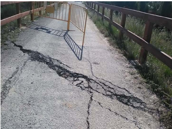
DC. Vista de las grietas aparecidas en la plataforma.
