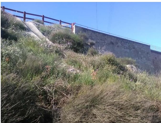
Vista de la bajante de aguas pluviales existente, la cual no ha entrado en funcionamiento.
