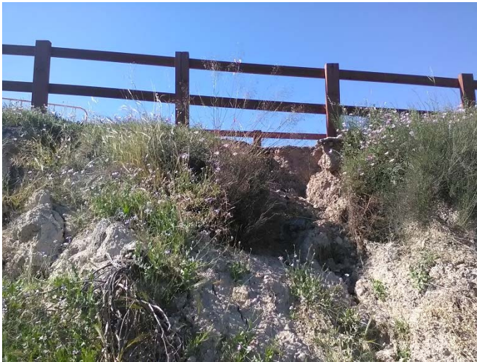
Vista desde la parte inferior del terraplén. Socavación producida.
