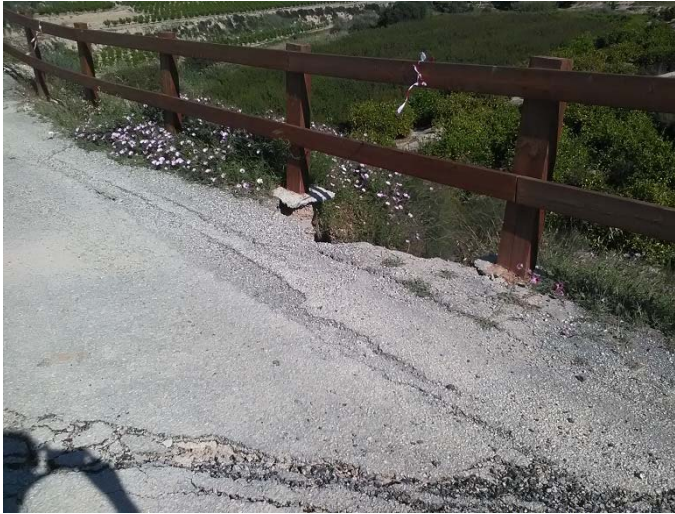
Vista de la talanquera de madera sin sustentación. Punto de evacuación de las aguas.
